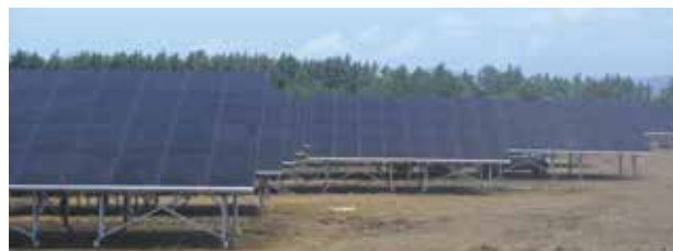
■六ヶ所村太陽光設備
